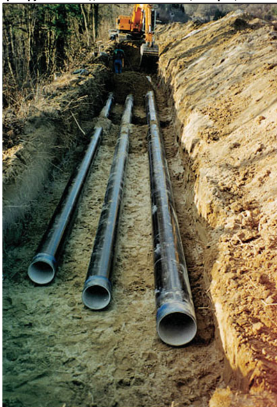
Рис. 1. Прокладка труб ДУ300+ДУ400 с ЦПФ и раструбными соединениями в Розегге, Австрия, 1998 г.
